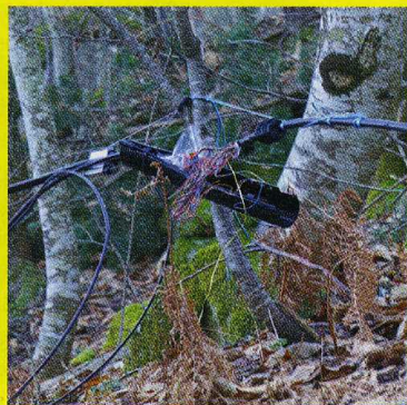
Les boîtes de connexion laissées à l'abandon...
